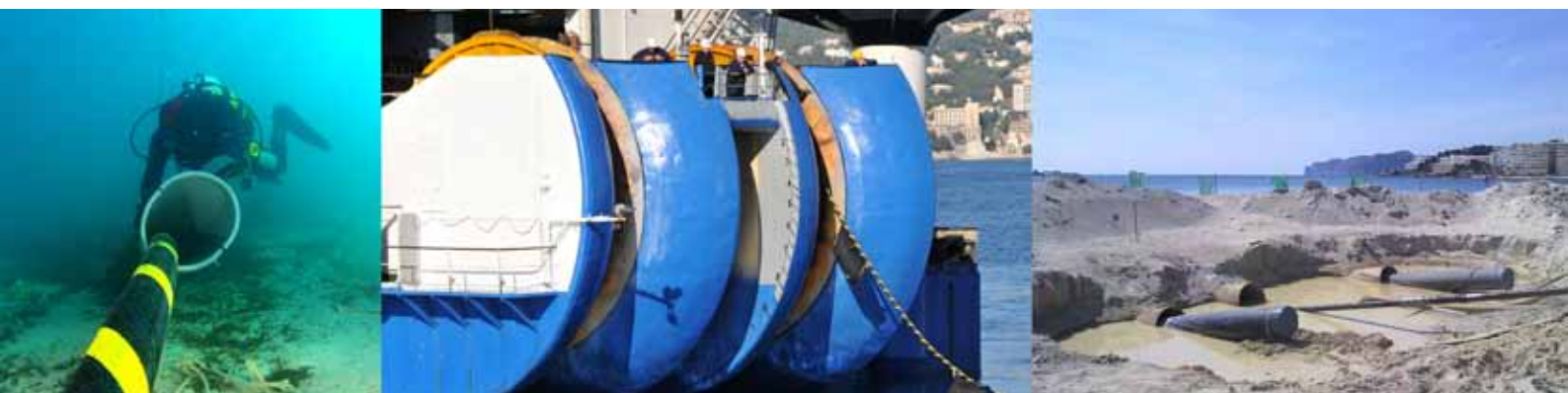
De izquierda a derecha: Un submarinista supervisa que el cable se ajuste al trazado establecido. Detalle de la popa del Giulio Verne . Área de empalme de cables en la playa de Santa Ponsa. Fuente: Tecnival Ingeniería y Red Eléctrica Española.
